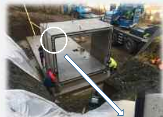
Die umlaufenden Gummi-Dichtungen zwischen den Bauteile zur Abdichtung.
